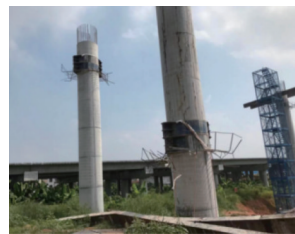
图2 钢抱箍滑移破坏现象
