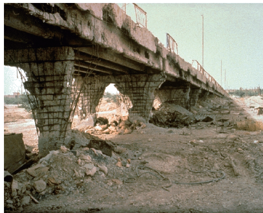
图 1 钢筋混凝土腐蚀情况
