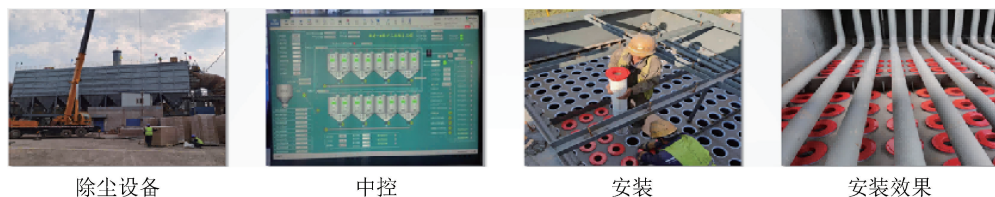
图 10 山西某炼钢厂除尘项目照片
