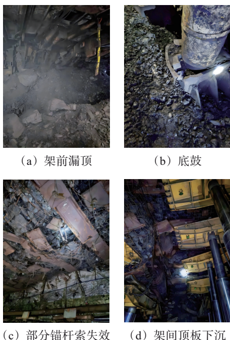
图2 井下矿压显现情况
