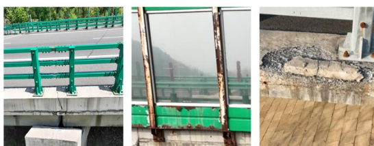
(a)桥体裂缝 (b)桥梁钢结构锈蚀 (c)桥侧大面积剥落
