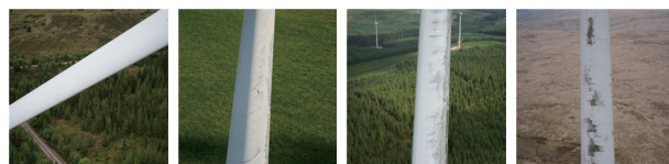
(a) 正常状态 (b) 叶片裂纹 (c) 叶片磨损 (d) 叶片破损
