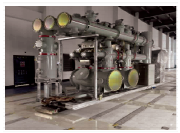
图 9 变电站 GIS 设备自动搬运实例
