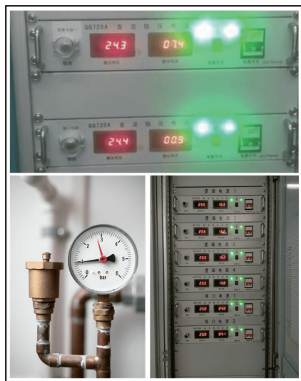
图1 机房设备巡检内容
