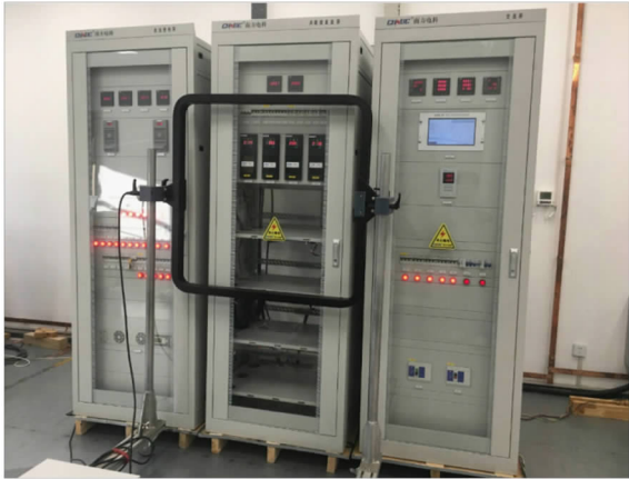
图 4 直流电源系统实物图
