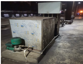
水箱和二次增压泵
