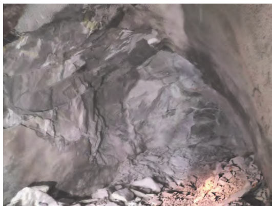
图 2 隧道岩爆爆坑
