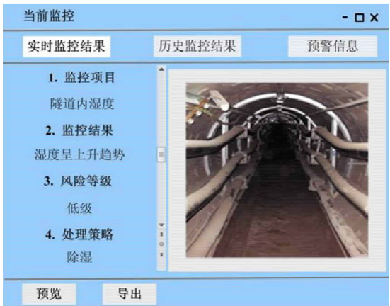
图 7 电力隧道湿度监控情况
