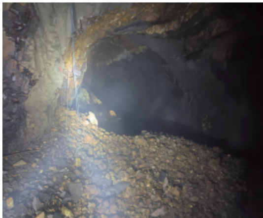
图5 现场塌方情况记录
